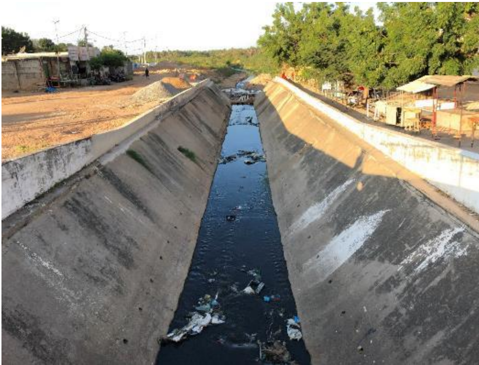
FIGURA 22. PC-09 – ESGOTO IN NATURA NO RIO GRANJEIRO.
