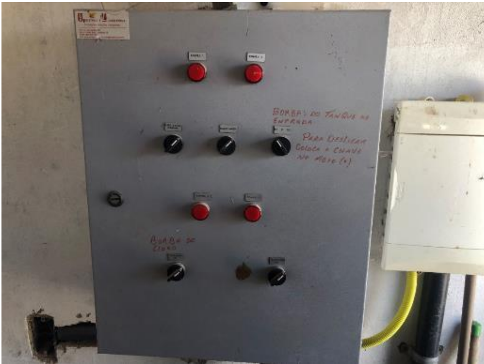
FIGURA 39. PAINEL ELÉTRICO DA ETE.
