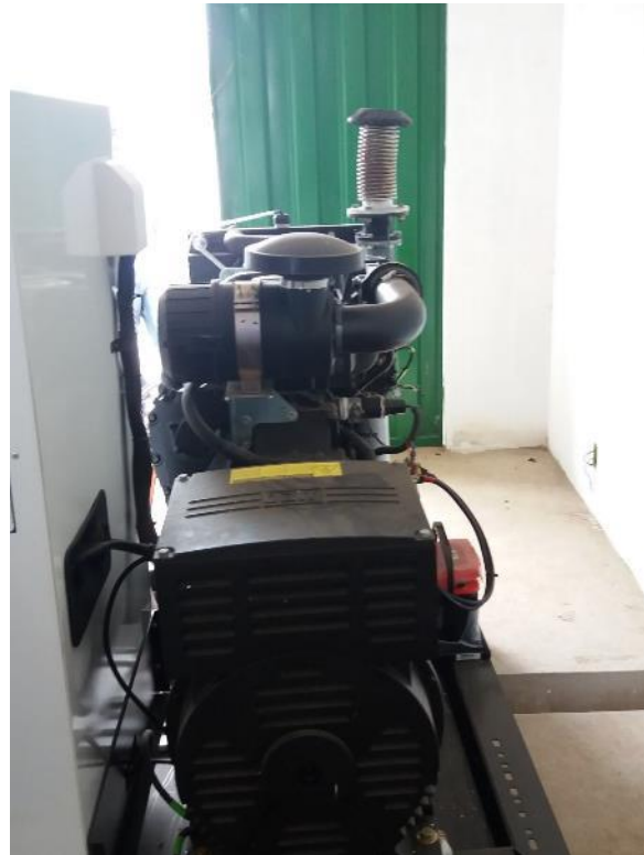
FIGURA 55. CASA DO GERADOR.
