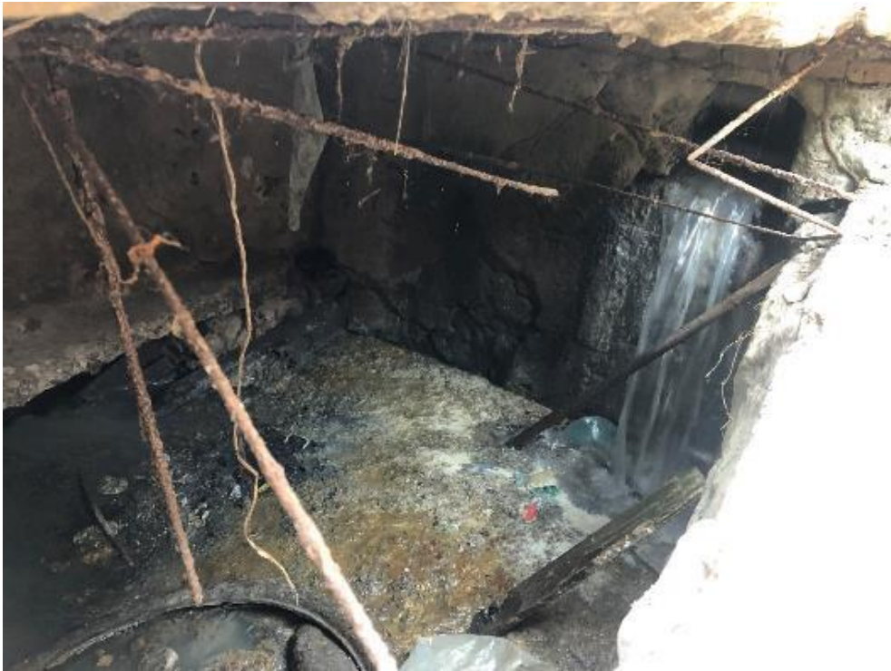
FIGURA 12. PC-02 – BY-PASS DA ETE VITÓRIA NOSSA (DESATIVADA).
