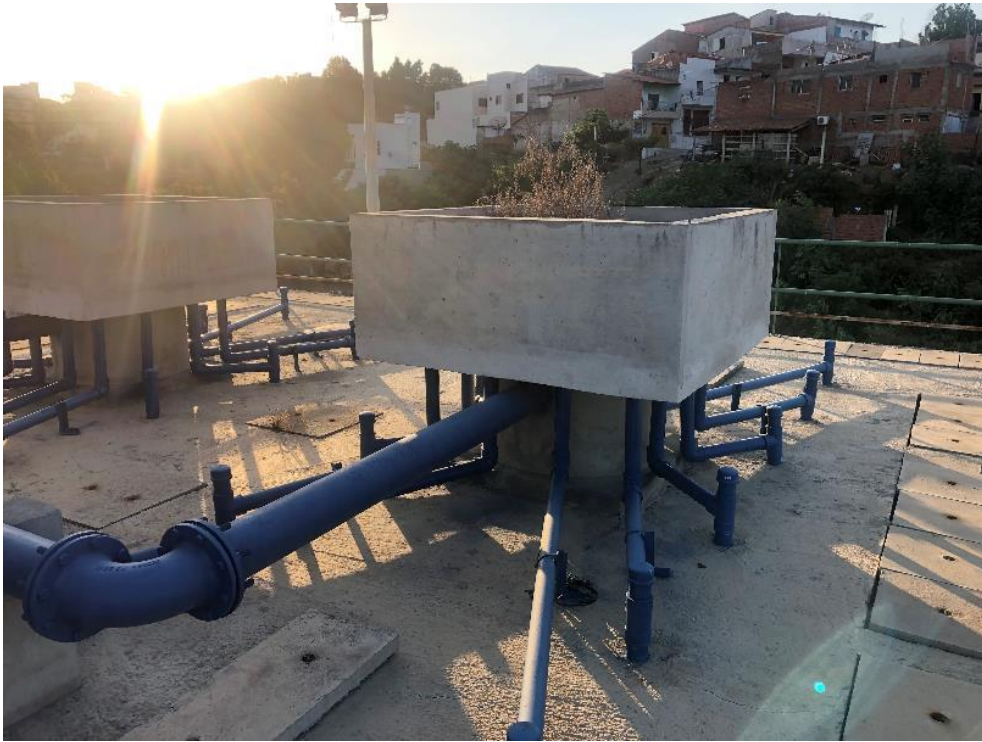
FIGURA 48. CAIXA DE DISTRIBUIÇÃO DE VAZÃO.
