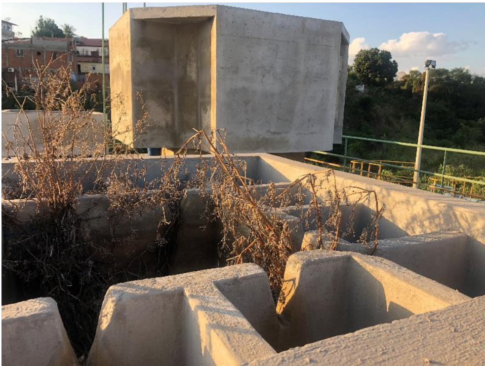
FIGURA 49. CAIXA DE DISTRIBUIÇÃO DE VAZÃO.
