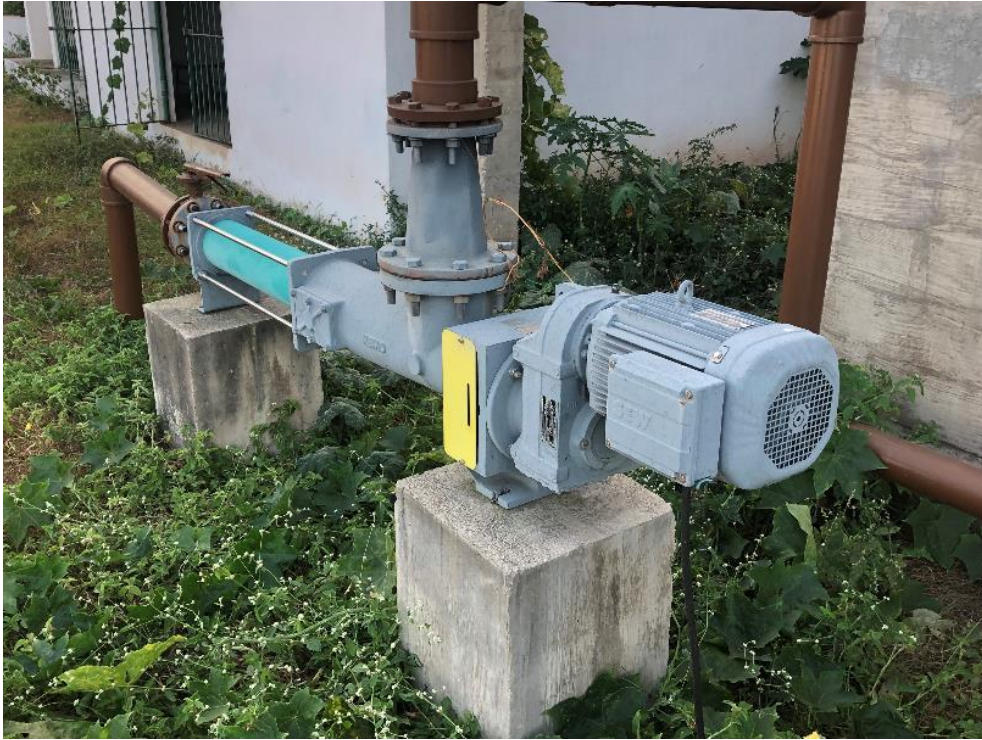
FIGURA 58. BOMBA DE EXCESSO DE LODO.
