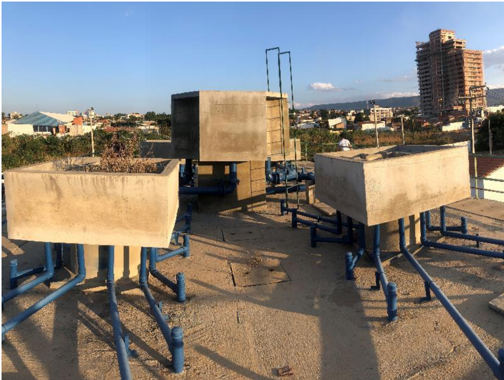
FIGURA 47. VISTA GERAL DA PARTE SUPERIOR DO UASB.
