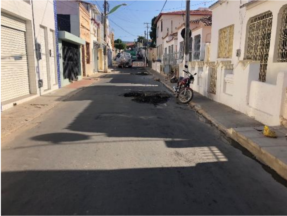
FIGURA 17. PC-07 – RUA COM FREQUENTE PONTO DE MANUTENÇÃO NA REDE COLETORA.
