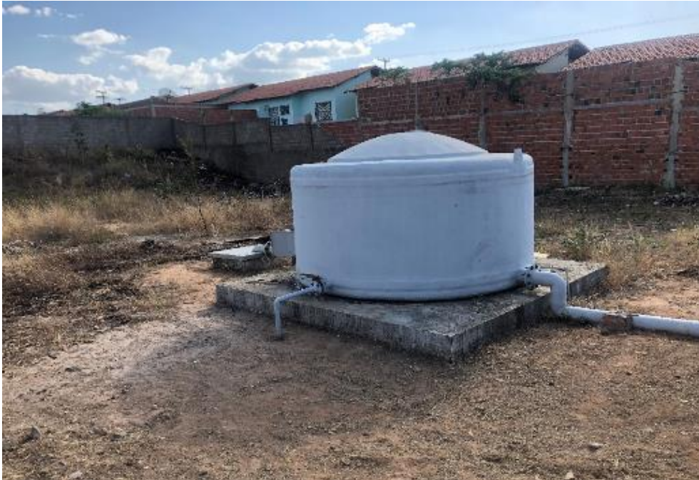
FIGURA 34. TANQUE DE CONTATO.
