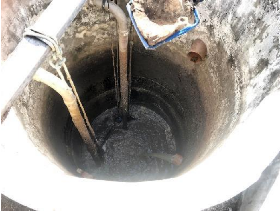
FIGURA 28. ESTAÇÃO ELEVATÓRIA DE ESGOTO.
