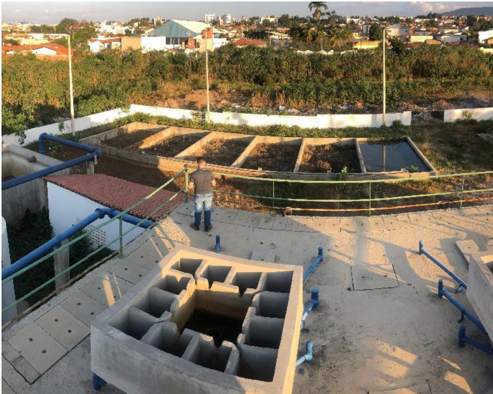
FIGURA 59. VISTA GERAL DOS LEITOS DE SECAGEM.
