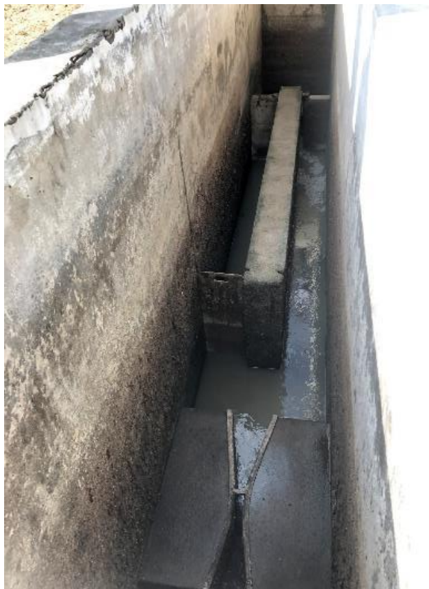
FIGURA 27. TRATAMENTO PRELIMINAR E CALHA PARSHALL DE ENTRADA.
