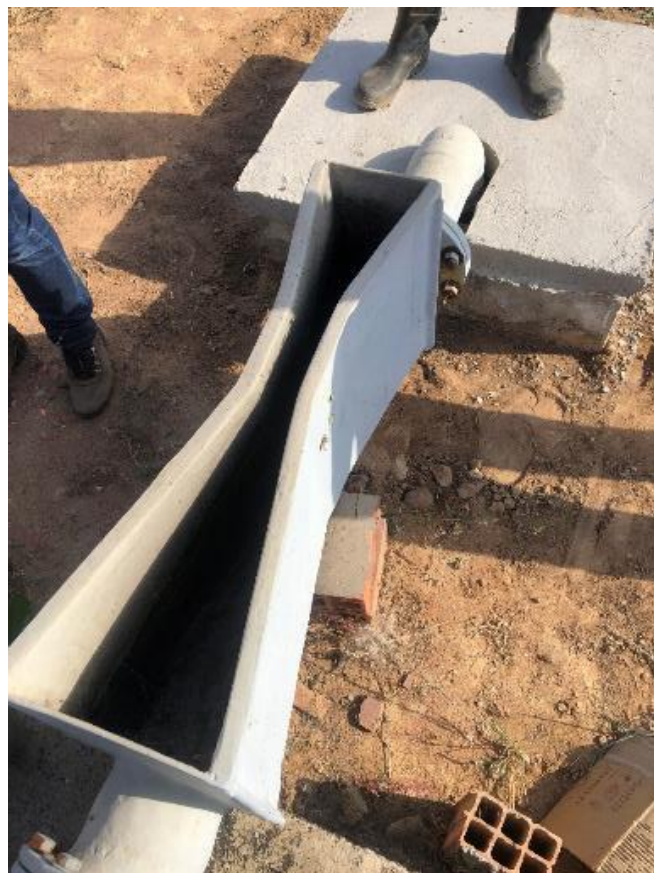
FIGURA 35. CALHA PARSHALL DE SAÍDA PARA MEDIÇÃO DE VAZÃO.
