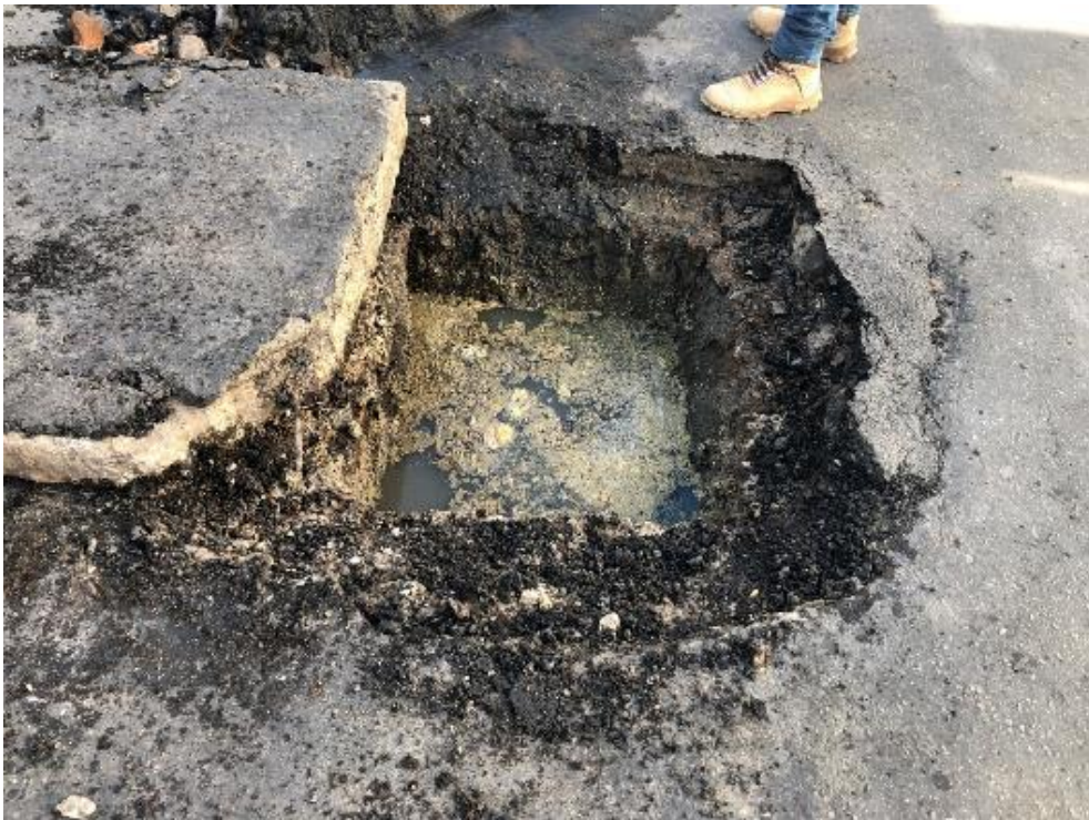
FIGURA 18. PC-07 – REDE COLETORA OBSTRUÍDA.
