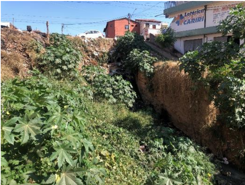
FIGURA 14. PC-04 - LANÇAMENTO DE ESGOTO A CÉU ABERTO.
