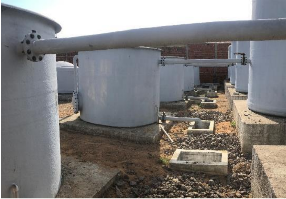
FIGURA 32. VISTA GERAL DOS REATORES AERÓBIOS E DECANTADORES.
