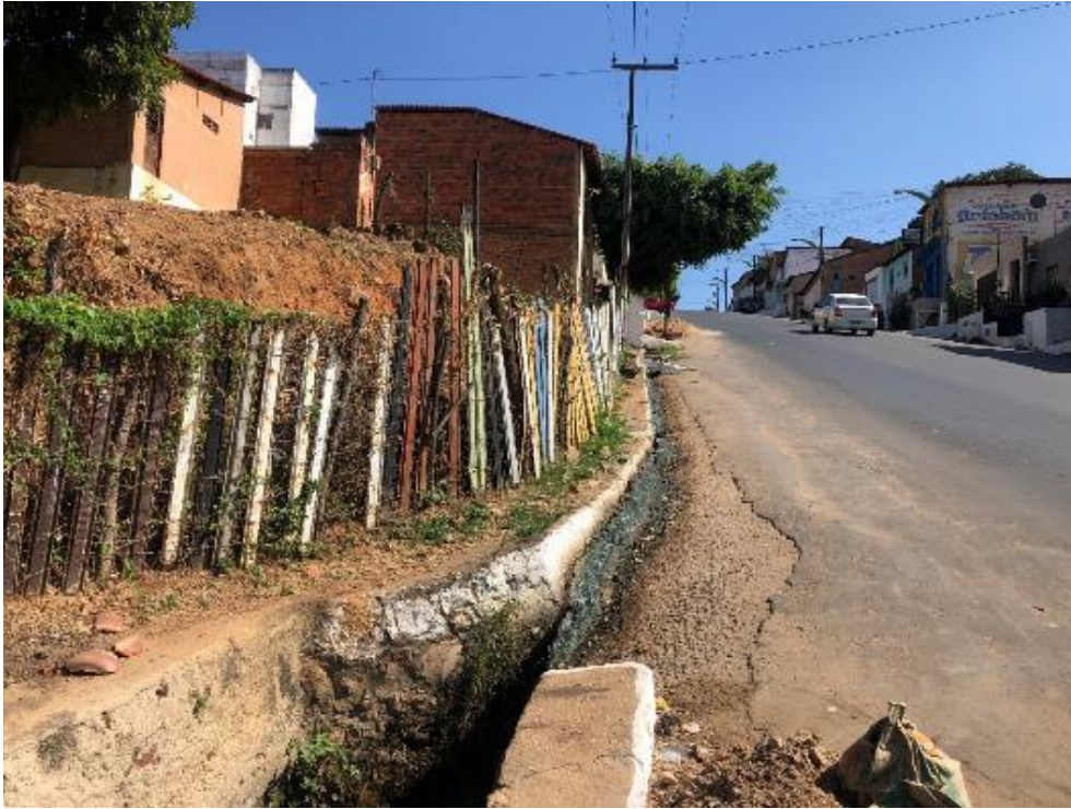
FIGURA 13. PC-03 - LANÇAMENTO DE ESGOTO A CÉU ABERTO.
