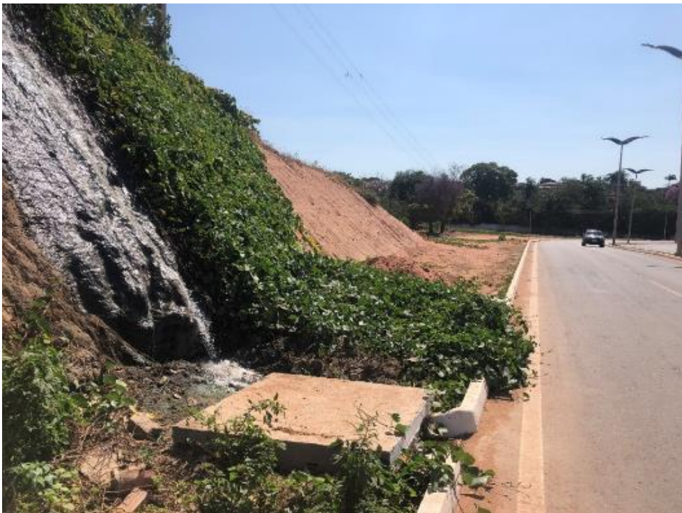
FIGURA 10. PC-01 - LANÇAMENTO DE ESGOTO A CÉU ABERTO.
