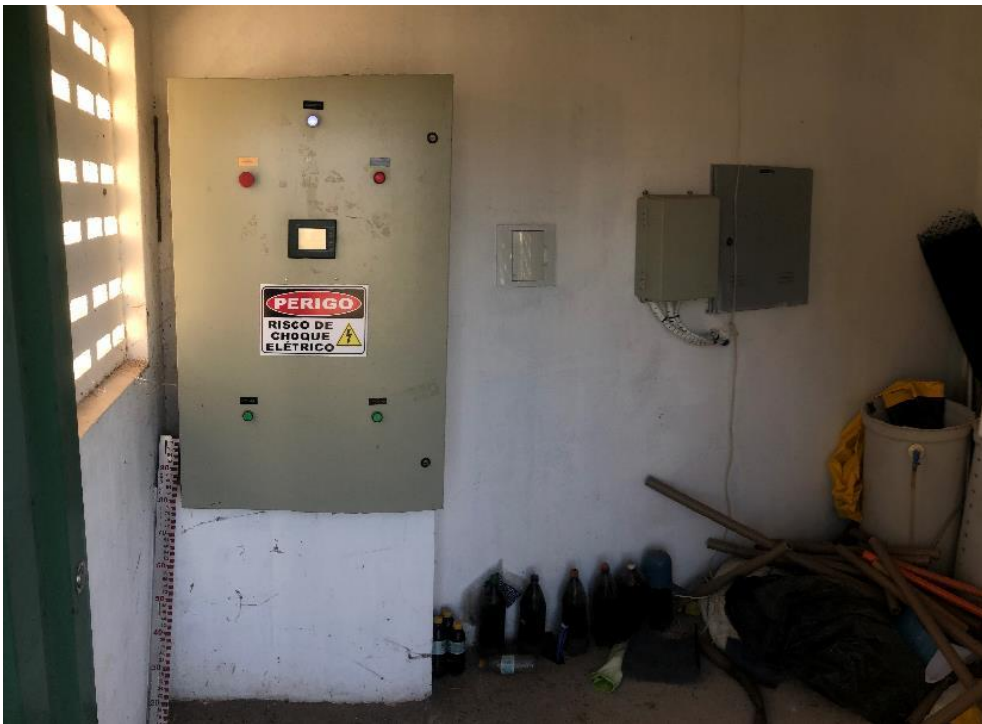
FIGURA 57. SALA DOS PAINÉIS.
