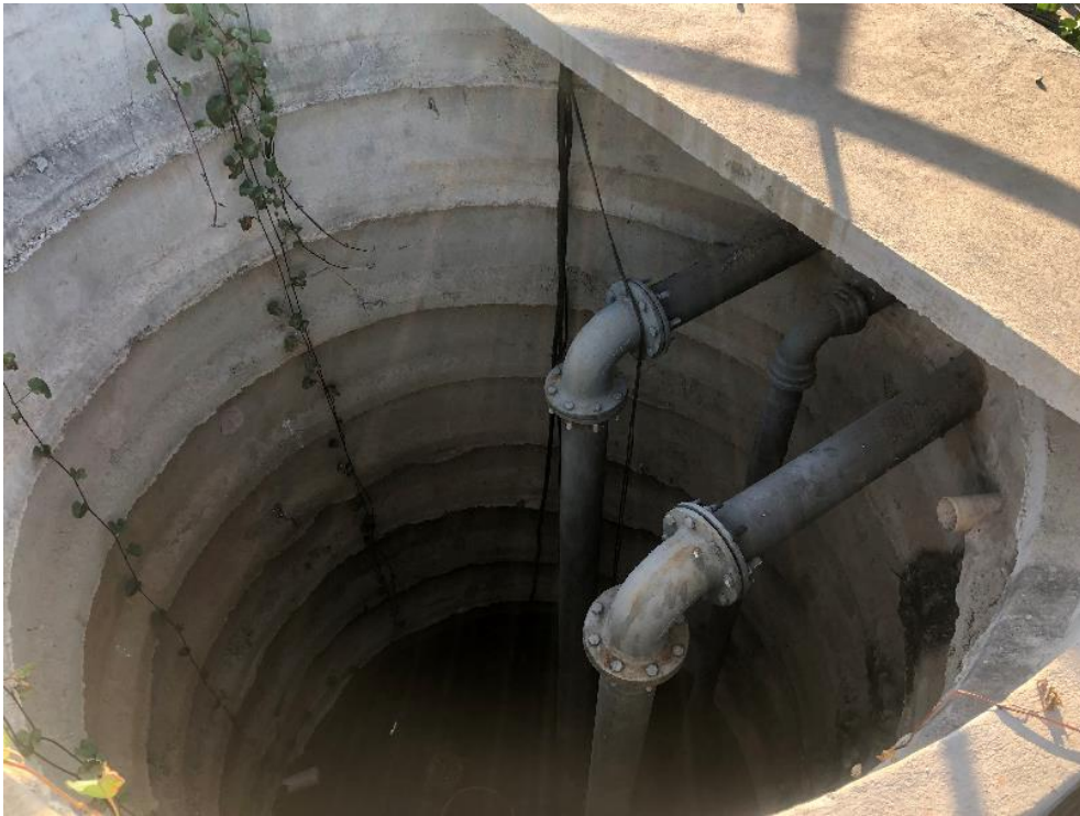
FIGURA 45. POÇO DE SUÇÃO DE EEE.
