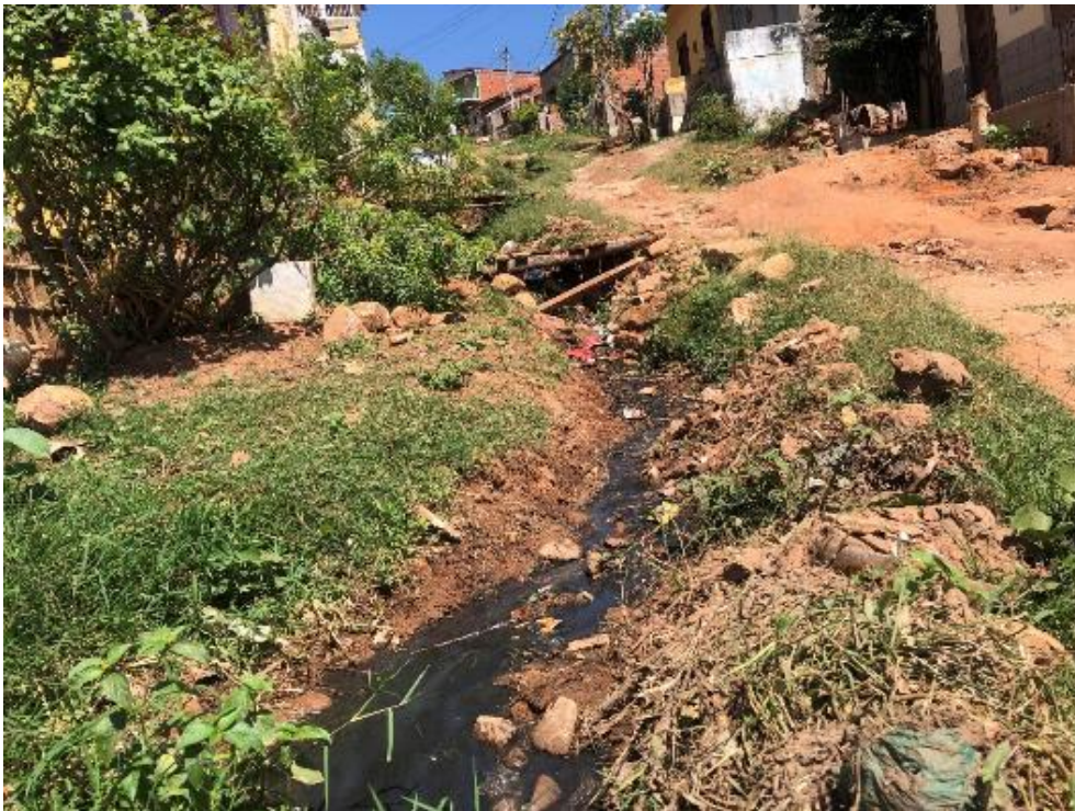
FIGURA 20. PC-08 - LANÇAMENTO DE ESGOTO A CÉU ABERTO.
