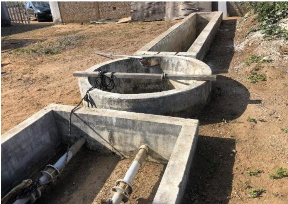
FIGURA 29. TRATAMENTO PRELIMINAR E ESTAÇÃO ELEVATÓRIA.
