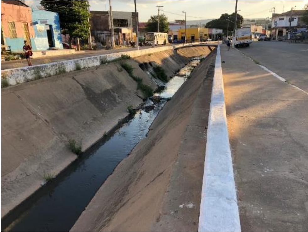
FIGURA 21. PC-09 - LANÇAMENTO DE ESGOTO NO RIO GRANJEIRO.
