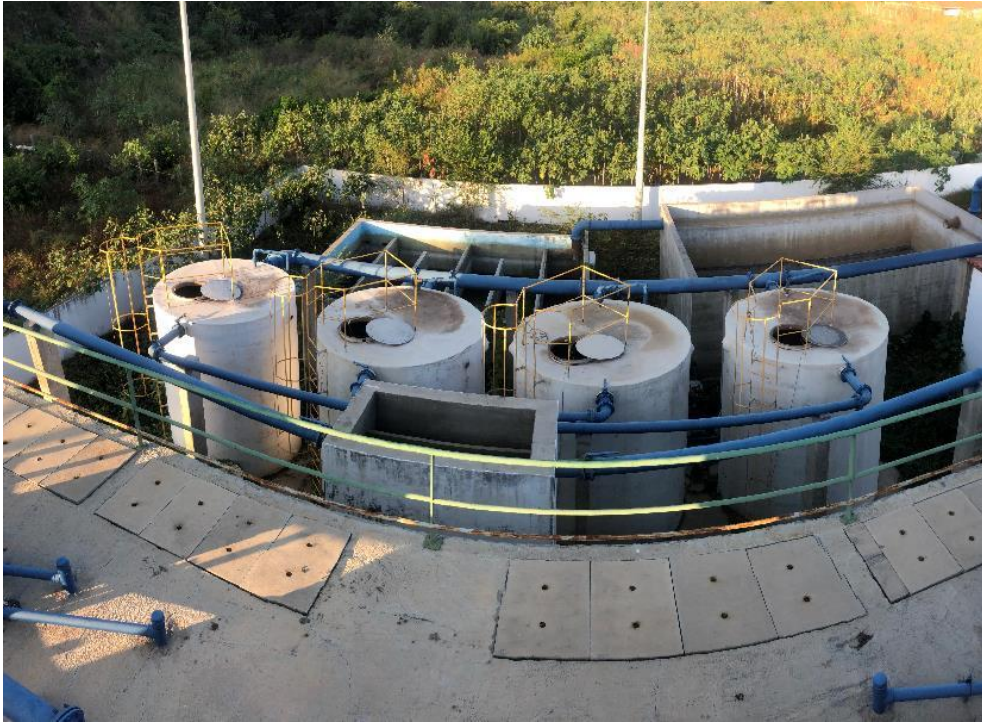
FIGURA 50. FILTROS AERADOS SUBMERSOS.
