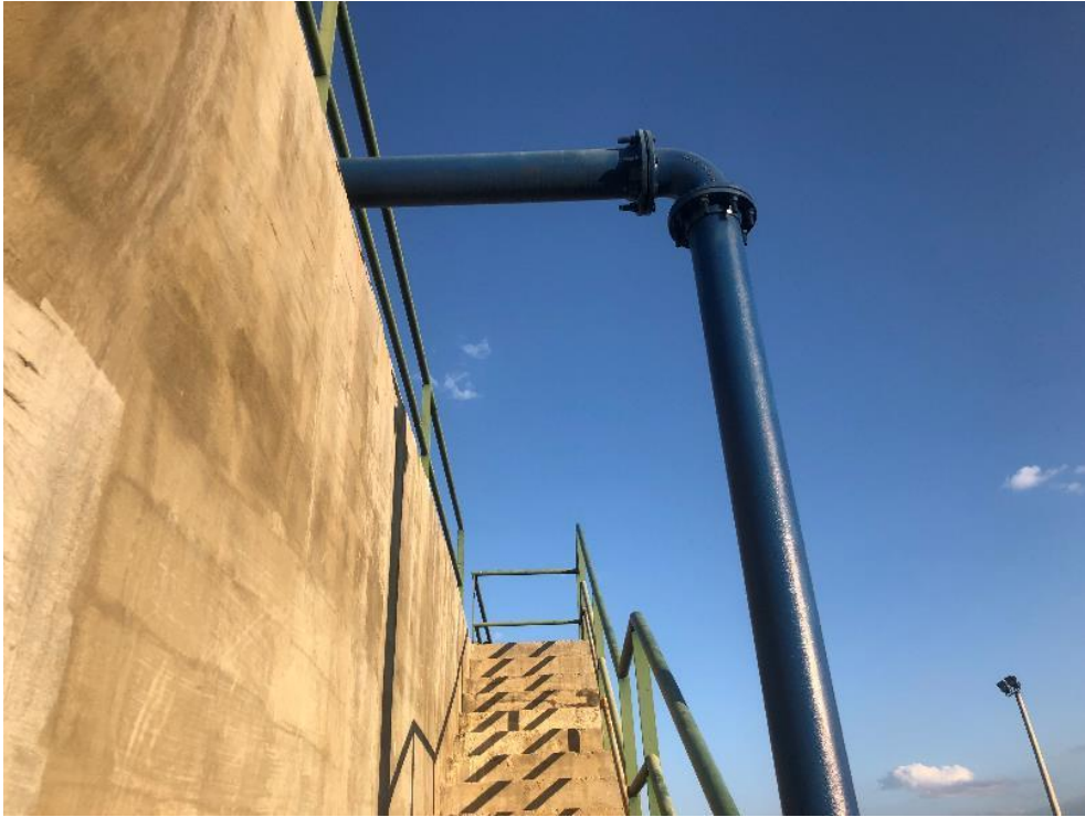
FIGURA 46. CHEGADA DE ESGOTO NO REATOR UASB.
