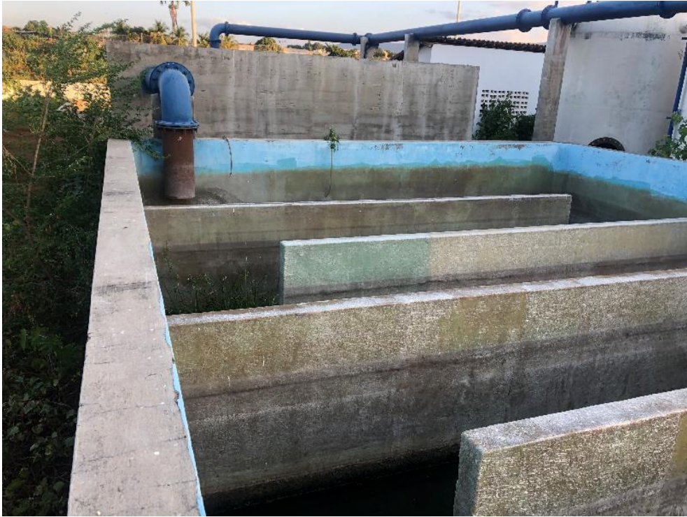
FIGURA 52. DECANTADOR E TANQUE DE CONTATO.
